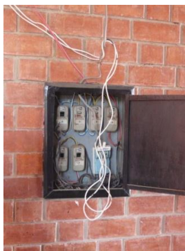
Figura 10 Instalaciones eléctricas precarias (Museo Regional de Casma %Max Uhle-)
