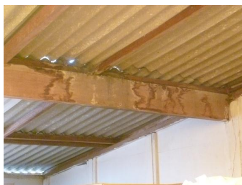
Figura 57 Filtraciones en los depósitos (Museo de Sitio Huallamarca)
